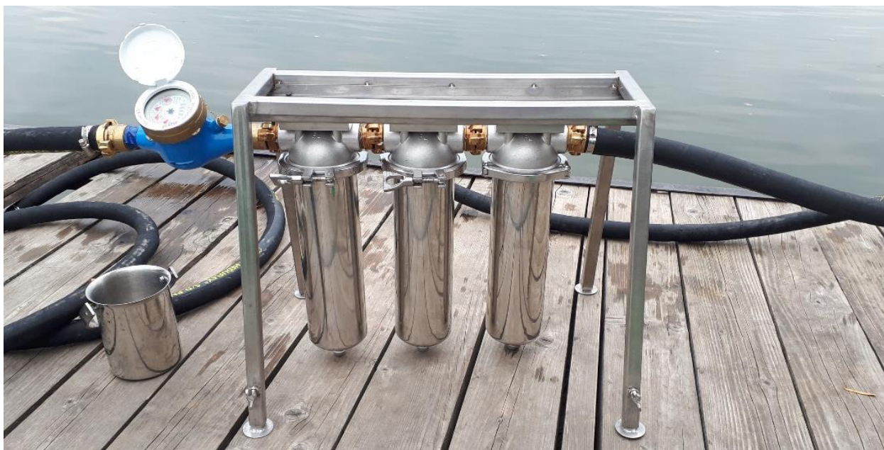
12. ábra: Sorba kapcsolt szűrők egyedi állványon és gumitömlő csatlakozások.
