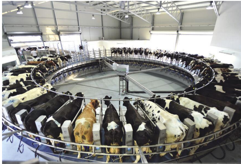
A vizsgált telepen megtalálható 60 férőhelyes karüsszeles fejőberendezés
