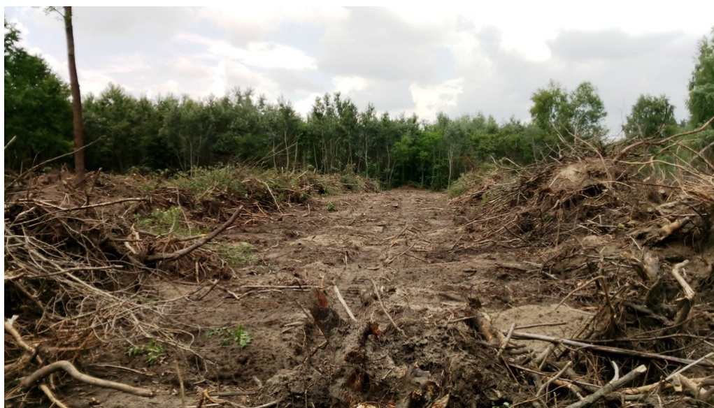
21. ábra. Tuskósorok kialakítása a Peszéri-erdőben mesterséges felújítási munkálatok során. A képen látható szituációban a tuskópásztákba halmozott faanyag aprítékolásra és elszállításra került
